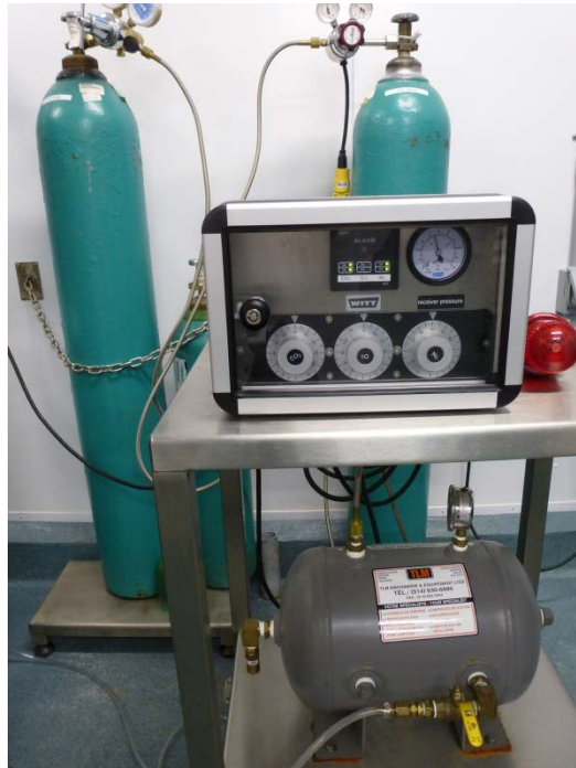
Mélangeur de gaz
